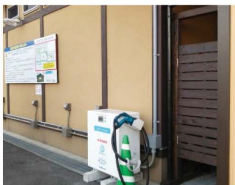
無料電源供給設備
