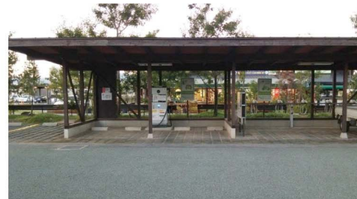
電気自動車・電気バイク充電設備
